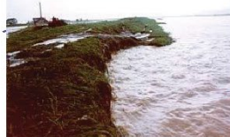
諫早市仲沖地区溢水による川裏崩壊
