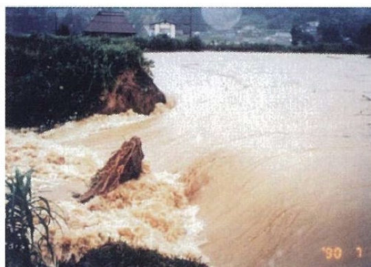
▲武雄市橋町の堤防決壊状況
