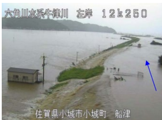
▲六角川水系牛津川における越水状況
