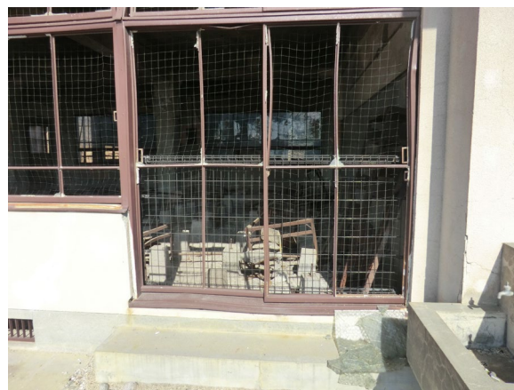
▲被災当時の状況を保存した小学校内部
