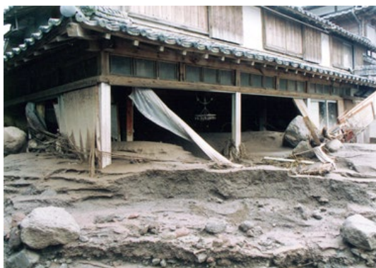
▲土石流被害を受けた家屋
