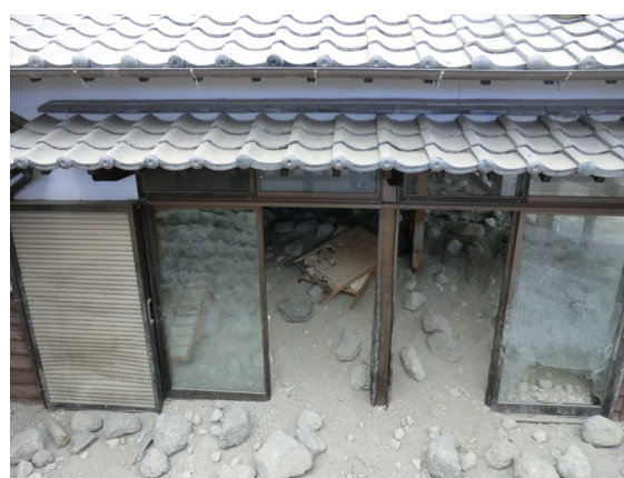
▲土石流被害を後世に伝える保存家屋
