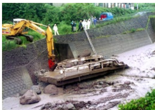
▲土石流の勢いで流された橋
