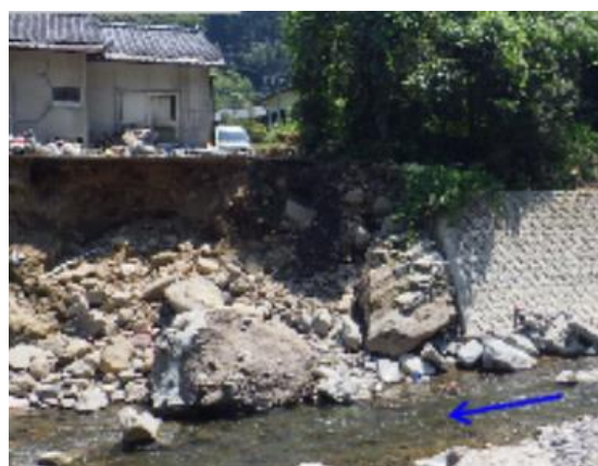
▲護岸が崩落した球磨川水系芋川
