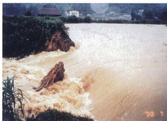
▲武雄市橘町の堤防決壊状況
