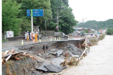
▲国道211号宝珠山駅前の道路崩落 (福岡県東峰村)
