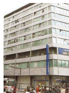
▲窓ガラスが破損した 福岡ビル (福岡市中央区)
